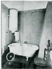
Fig. 8. — Installation d'un chauffe-eau mural de 100 litres réalisée à Gertwiller (Bas-Rhin) dans un coin d'une chambre à coucher entre le mur et la grande cheminée qui monte de la cuisine. Au premier plan, on distingue le radiateur électrique et à droite, le lit.
