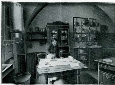
Fig. 5. — Voici une ménagère qui apprécie les bienfaits de l'électricité. A gauche, on distingue le chauffe-eau de 50 litres, et à droite, la cuisinière électrique avec four. Cette installation a été réalisée à Sélestat en 1922.
